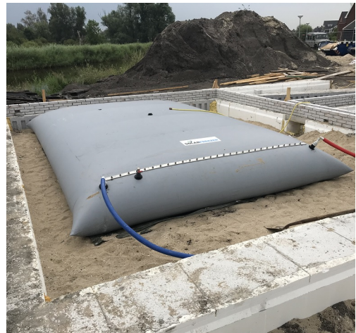
Het systeem van SolarFreezer werkt met een bufferzak in de kruipruimte.
